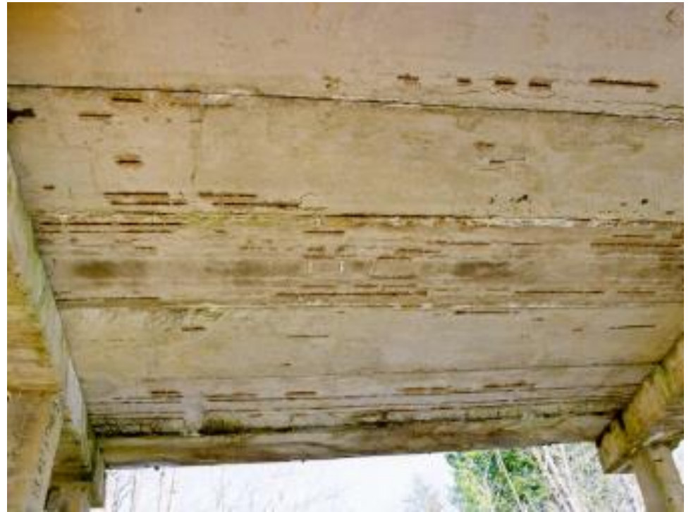
Korozija armature izazvana karbonatizacijom
